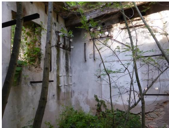
Estança del quadre de comandament de la central elèctrica.
