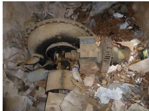
Turbina Francis de conducte forçat.
